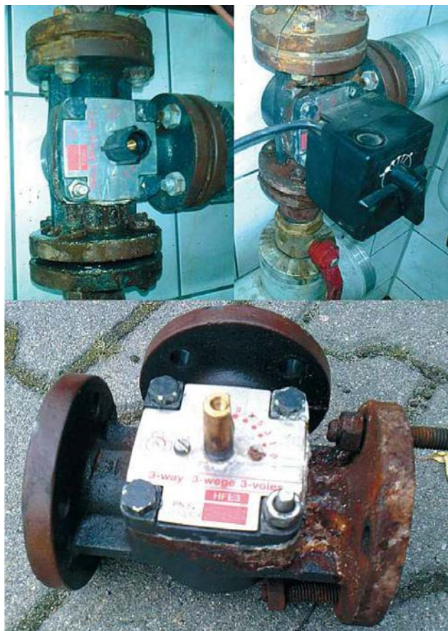
Korozja na zaworze mieszającym spowodowana złą jakością wody kotlewej Fot. M. Mulik, M. Bożym
