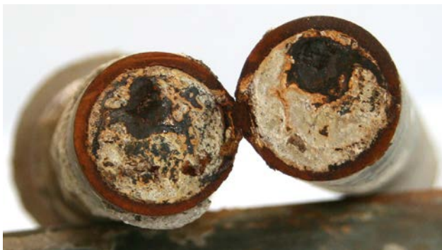
Przekrój niedrożnego przewodu z instalacji c.w.u. z osadami kamienia kotłowego Fot. WJ
