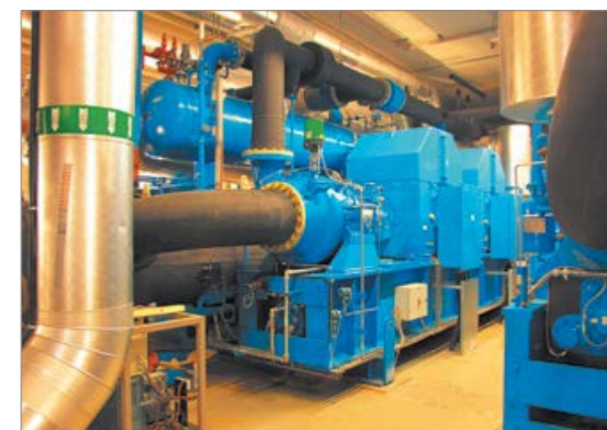
Fot. 1. Widok instalacji i pomp ciepła w Fornebu na osiedlu Rolfsbukta Fot. Friothers
