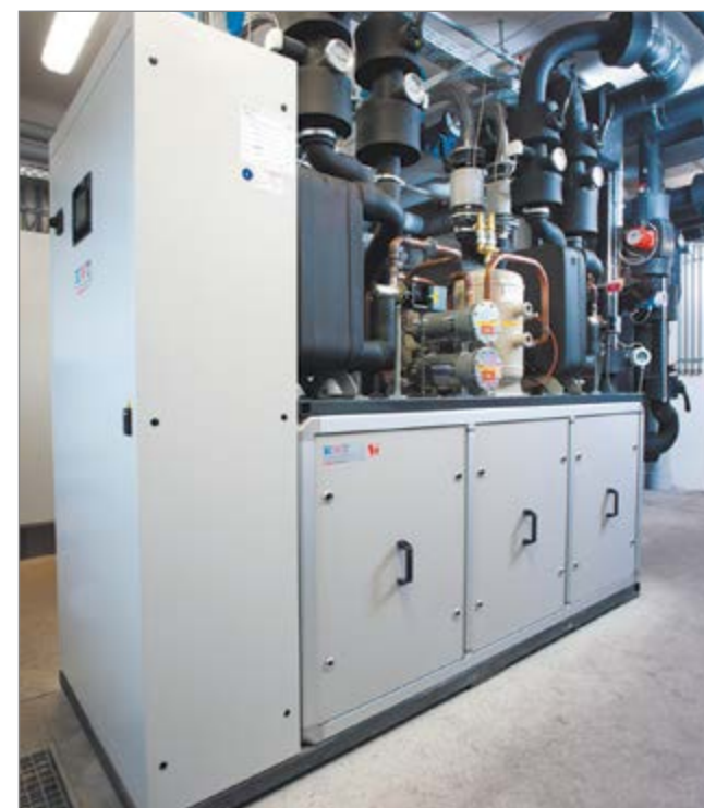
Fot. 4. Pompy Vitocal 300 w instalacji grzewczej hali zakładu prefabrykowanych konstrukcji betonowych Fot. Laumer Bautechnik
