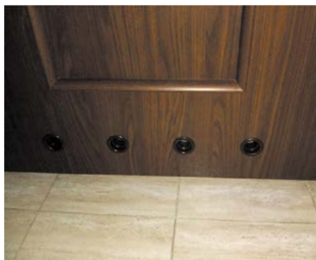
Fot. 1. Otwory w drzwiach do łazienki [4] niespełniające wymagania dotyczące minimalnej powierzchni – 200 cm 2
