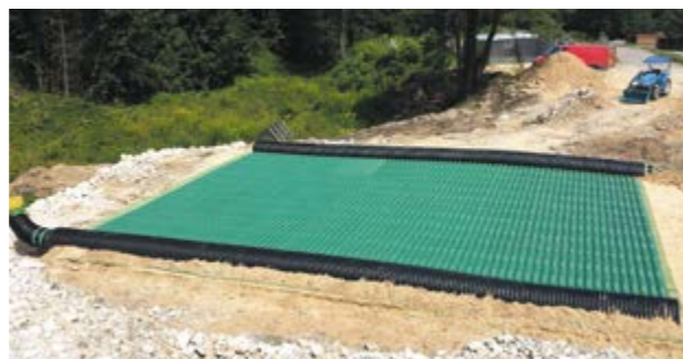
Fot. 2. Widok powietrznego gruntowego wymiennika ciepła Geostrong [23]
