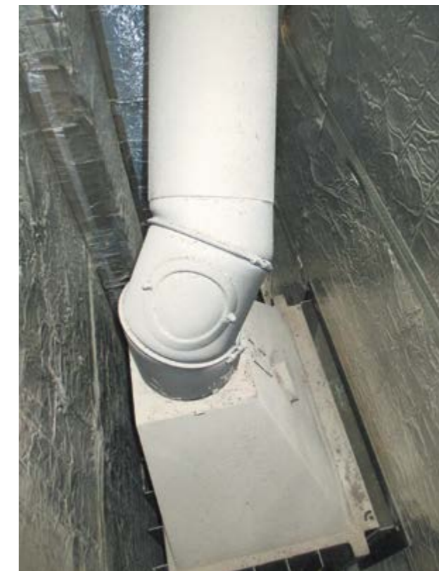
Rys. 2. Wkład kominkowy i przewód kominowy pokryty pyłem (kurzem) na całej powierzchni po kilku sezonach użytkowania
