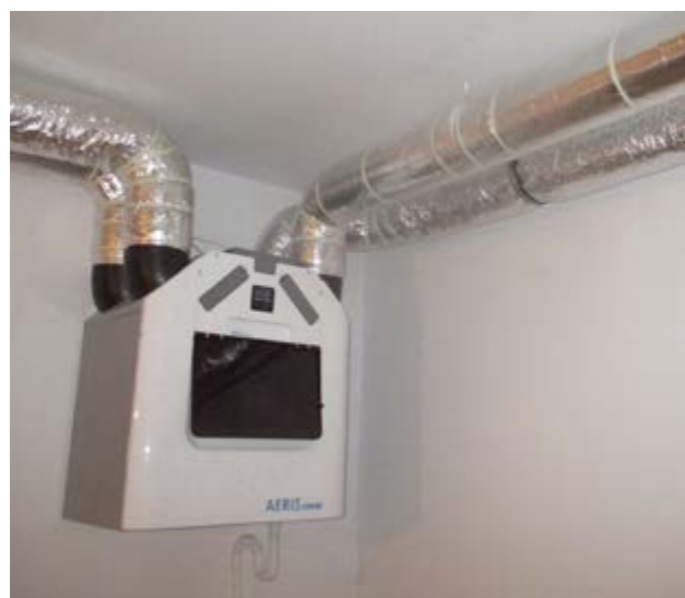
Rekuperator AERISnext 350 podwieszony pod sufitem
