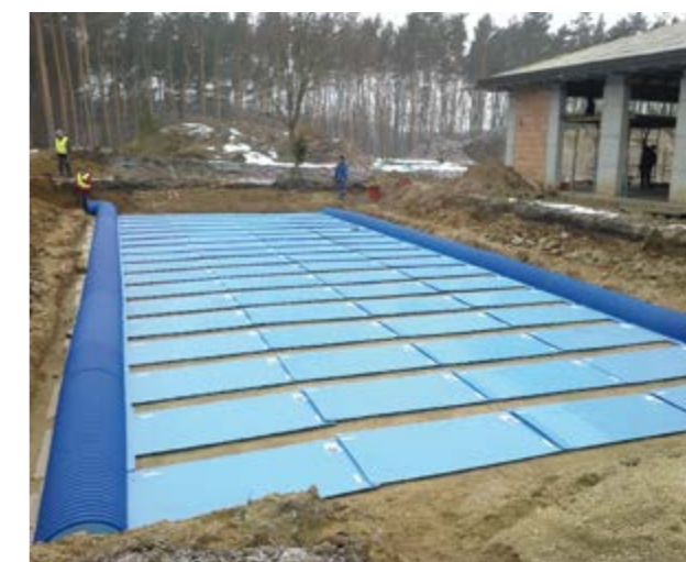
Fot. 1. Widok powietrznego gruntowego wymiennika ciepła Pro-Vent [23]
