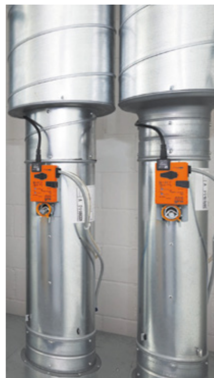
Rys. 2. Kontrola przepływu objętościowego i ciśnienia powietrza. Czułe czujniki w połączeniu z siłownikami umożliwiają precyzyjną rejestrację zmian ciśnienia i kontrolę nawet najmniejszych przepływów objętościowych. Integracja z systemem zarządzania pozwala na sterowanie wentylatorami i regulację kłap w wielu strefach. Źródło: Belimo
