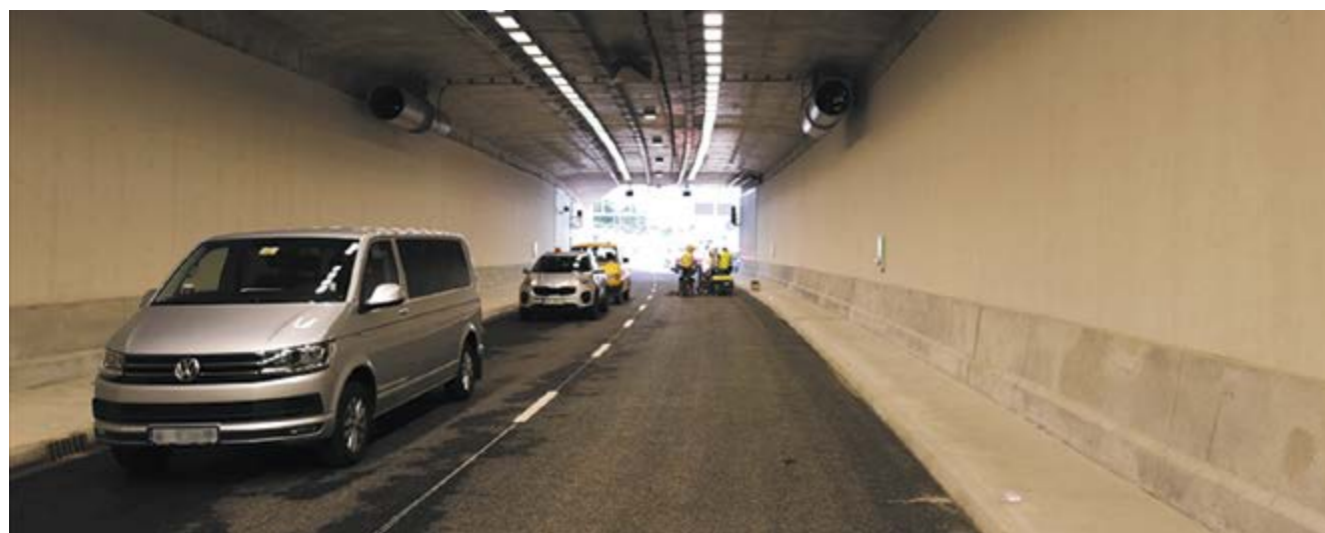
Fot. 6. Portal wjazdowy do nawy tunelu drogowego – oddymianie przeciwne do kierunku poruszania się samochodów daje najlepsze efekty Źródło: Neuron
