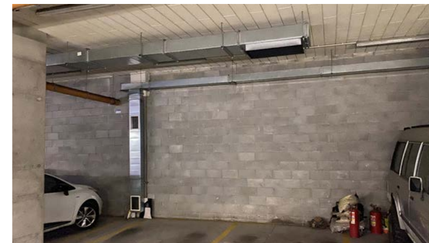
Fot. 1. Nawiew i wywiew wentylacji kanałowej Źródło: arch. autora
