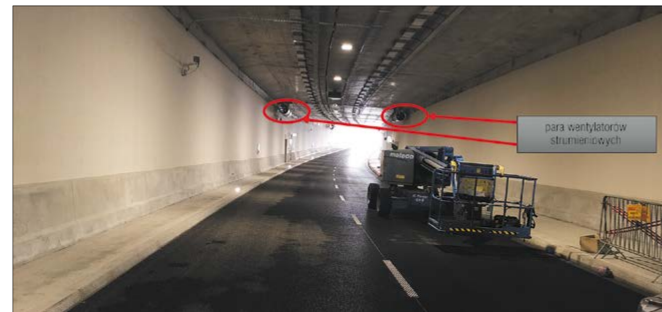
Fot. 1. Wentylacja wzdłużna tunelu – widok pary wentylatorów strumieniowych
