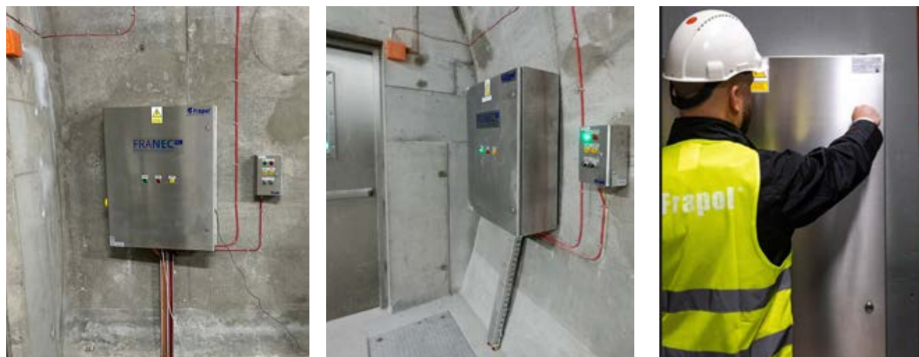
Rys. 3. Szafa sterownicza w wykonaniu ze stali nierdzewnej
