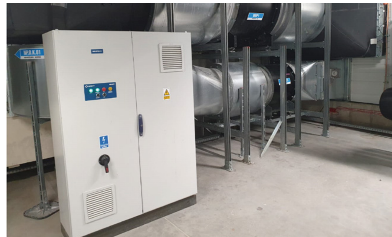
Fot. 1. Urządzenia zestawu różnicowania ciśnienia w przykładowym obiekcie
