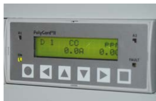
Fot. 1. Przykładowa centrala wskazująca jednocześnie dwa pomiary: bieżący (C) i średni (A)
