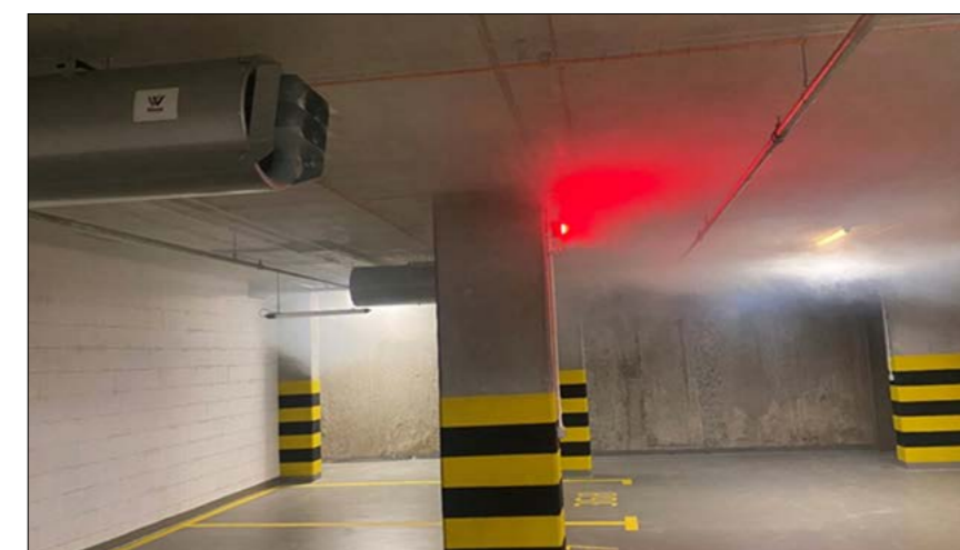
Fot. 3. Ukierunkowanie gorącego dymu przez wentylatory strumieniowe Źródło: arch. autora
