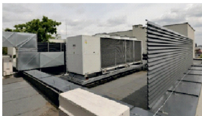
Rys. 3. Powietrzna pompa ciepła zainstalowana na dachu płaskim budynku wielorodzinnego Źródło: archiwum autora
