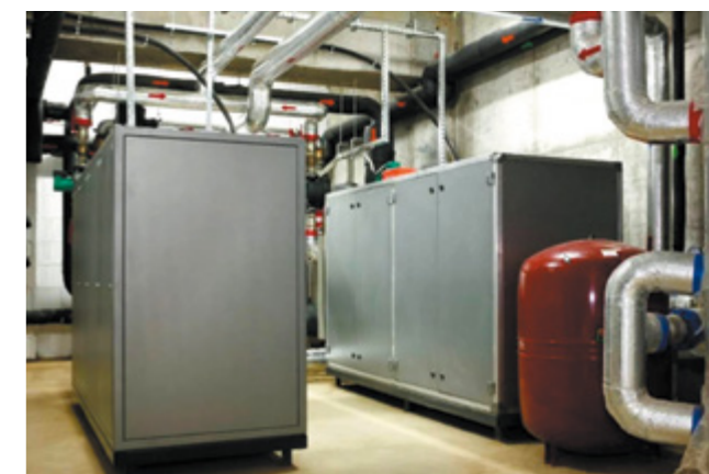
Rys. 4. Hybrydowa maszynownia z kaskadowymi gruntowymi pompami ciepła Źródło: archiwum autora
