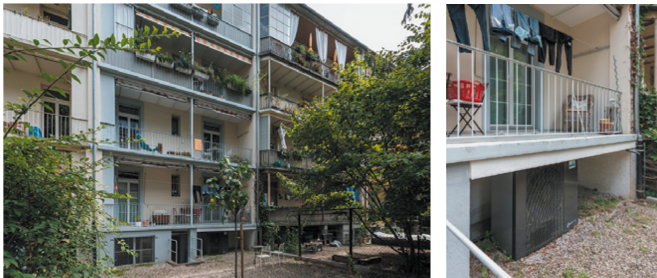
Fot. 3. Pompa ciepła ulokowana na fundamencie betonowym przy ścianie, z zabezpieczeniem przed emisją hałasu [10]
