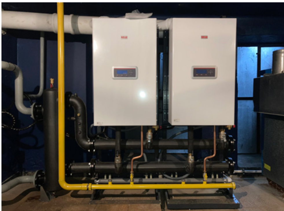
Fot. 1. Zmodernizowana kotłownia – kaskada dwóch kotłów w Wyższej Szkole Promocji Zdrowia w Krakowie
