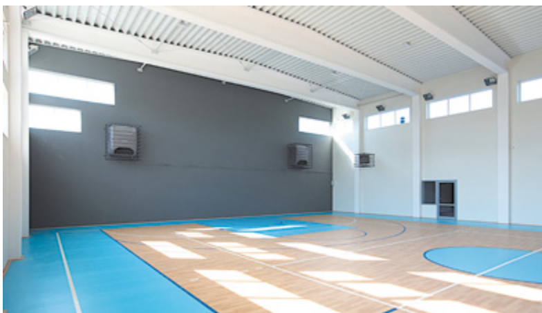
Prawidłowo wentylowana mała sala gimnastyczna z zastosowaniem urządzeń bezkanałowych (Żywiec) Fot. Flowair
