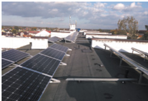
Kompleks szkolny w Niepołomicach po modernizacji z zastosowaniem pomp ciepła i paneli fotowoltaicznych Fot. Gmina Niepołomicze
