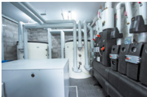
Kotłownia szkolna z pompami ciepła w Zespole Szkół w Chudku (gm. Kadzidło) – po głębokiej termomodernizacji Fot. Krzysztof Chojnacki dla UG Kadzidło
