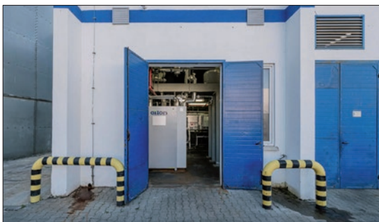
Fot. 1. Pompa ciepła na czynnik R450A, wykorzystująca ciepło odpadowe i podnosząca efektywność energetyczną instalacji grzewczo-chłodzącej, zastosowana w zakładzie produkującym świece. Moc grzewcza wynosi 144 kW, zaś wydajność chłodnicza 86 kW. Współczynnik opisujący efektywność jednoczesnego grzania i chłodzenia TER = 3,83 . Zastosowanie tego procesu pozwala na 400 tys. zł oszczędności rocznie
