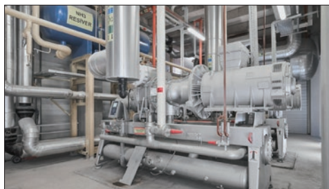
Fot. 5. Instalacja chłodzenia amoniakalnego wymaga odpowiedniego systemu detekcji, scharakteryzowanego w wymaganiach prawnych dla konkretnych zakładów
