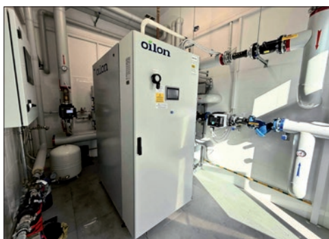
Fot. 1. Wysokotemperaturowa pompa ciepła woda-woda (moc grzewcza 160 kW) o COP = 5,35 pracująca w Odlewni Roztocze. Dolnym źródłem jest ciepło odpadowe z pieców odlewniczych, a górnym – ogrzewanie podłogowe (biura) oraz nagrzewnice wodne (produkcja) Źródło: Gazuno
