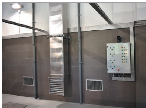
Fot. 6. Wejście do pomieszczenia zagłębionego w budynku krat wymaga zbadania zawartości tlenu oraz wyposażenia w detektor przenośny
