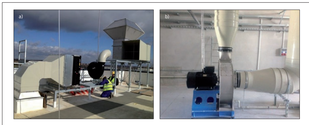
Fot. 2. Przykłady zastosowań elementów systemów wentylacji chemooodpornej: a) instalacja na dachu fabryki kosmetyków, b) wentylator chemooodporny i kanały okrągłe chemooodporne w kompostowni Źródło: Chemowent
