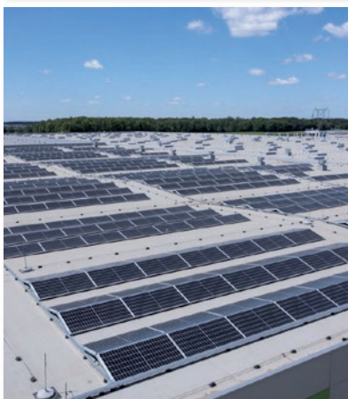
Fot. 4. Przykładowe instalacje fotowoltaiczne przeznaczone dla zakładów przemysłowych: a) wiatra parkingowa (źródło: Bentley Motors), b) ściana solarna (źródło: WPIP), c) system PV na dachu obiektu magazynowego (źródło: MPL)
