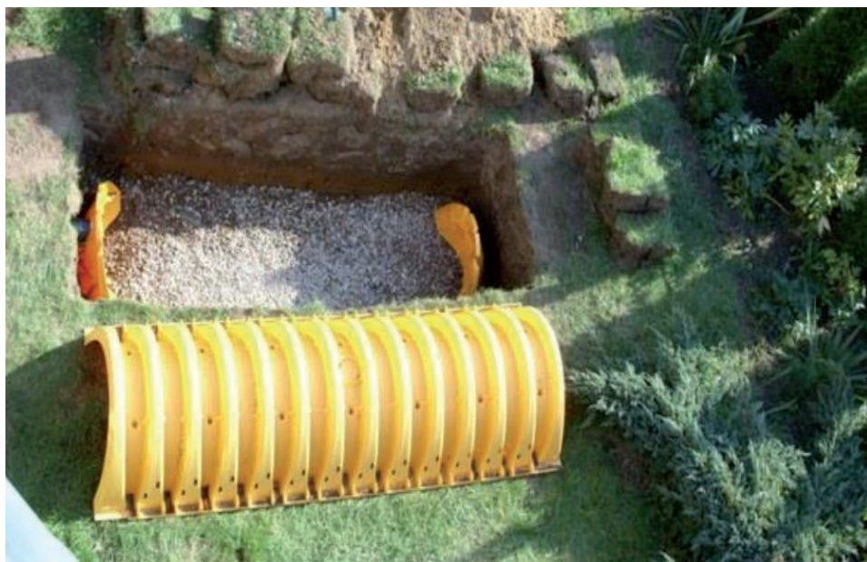
Fot. Komora drenażowa dla domu jednorodzinnego.
