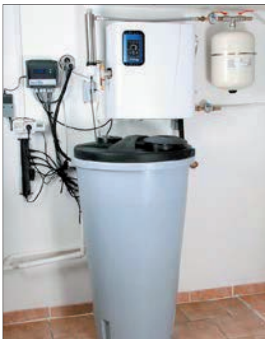
Fot. Instalacja uzdatniania wody deszczowej do jakości wody pitnej w budynku jednorodzinnym w Kelmis, Belgia /Źródło: MPI/Intewa/
