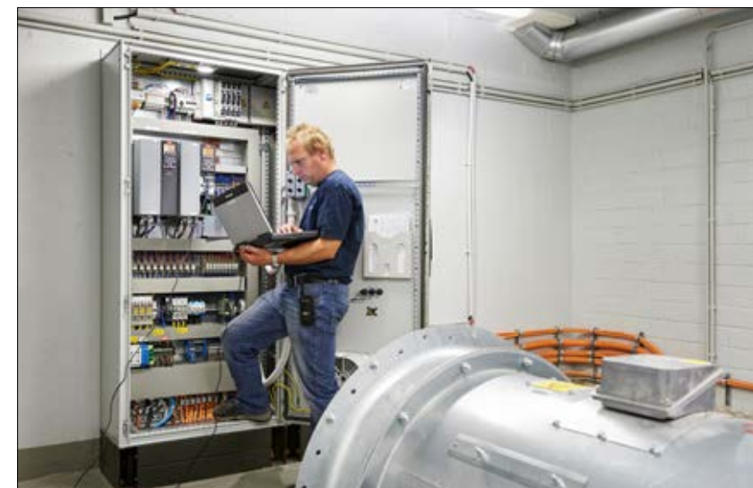
Rys. 3. Centrala zasilająco-sterująca wentylacją pożarową z przemiennikami częstotliwości
