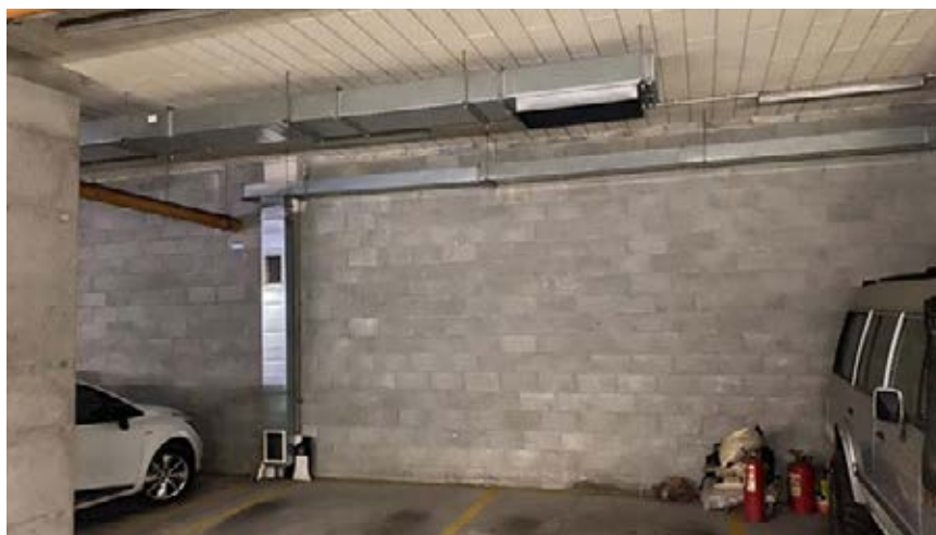
Fot. 1. Nawiew i wywiew wentylacji kanałowej
